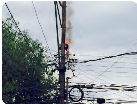
Fuego en cableado eléctrico
